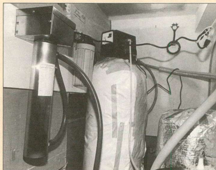
Le système de filtration à rayons ultra-violet, accompagné d'un dispositif destiné à adoucir l'eau. Une solution imparfaite, puisqu'il revient à la garderie de l'entretenir, de le nettoyer et de faire effectuer les analyses annuelles.
