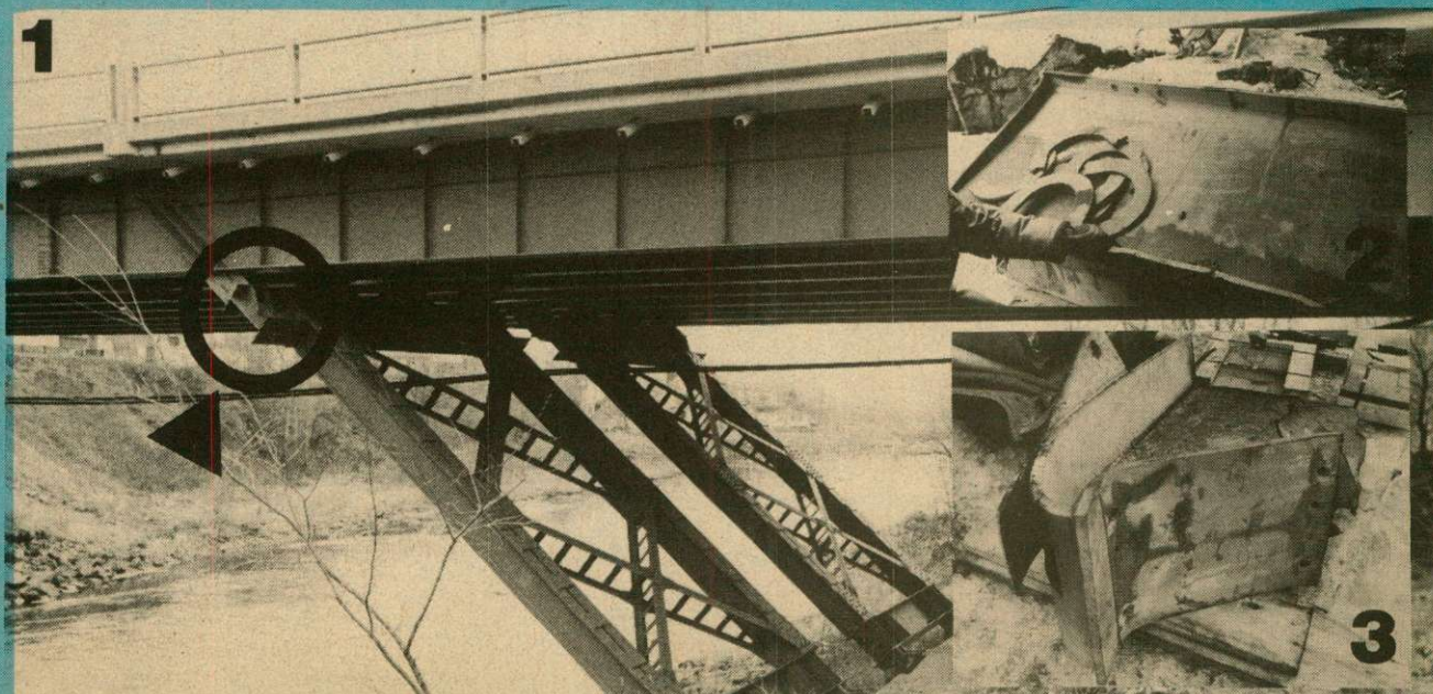
L'endroit où le pont a lâché (photo 1: photo d'un pont similaire), et quelques-unes des parties qui ont été projetées suite à l'effondrement (photos 2 et 3). A noter à quel point la plaque de transfert et la béquille ont été écrasées par la charge trop lourde à supporter (photo 3).
